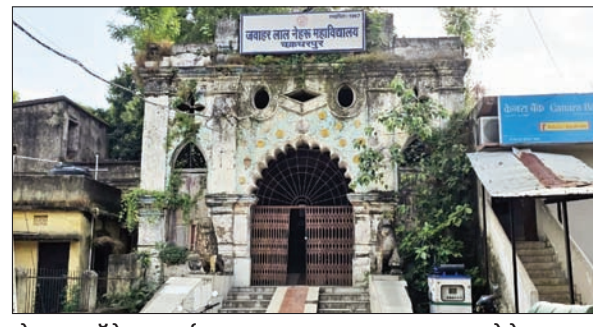
जेलएलएन कॉलेज का जर्जर भवन
